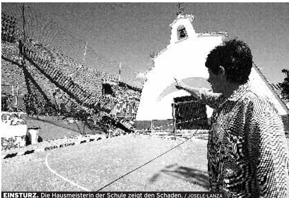
EINSTURZ. Die Hausmeisterin der Schule zeigt den Schaden. / JOSELE-LANZA
